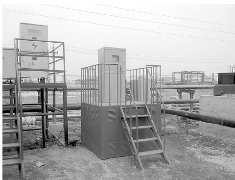
油井井下多点温度压力动态检测系统现场工况
