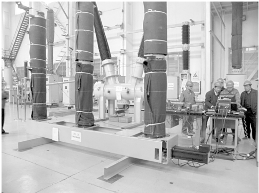
高压断路器新型旋转电机操动机构现场照片
