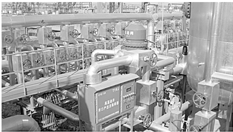
高温高压取样器现场工作照片
